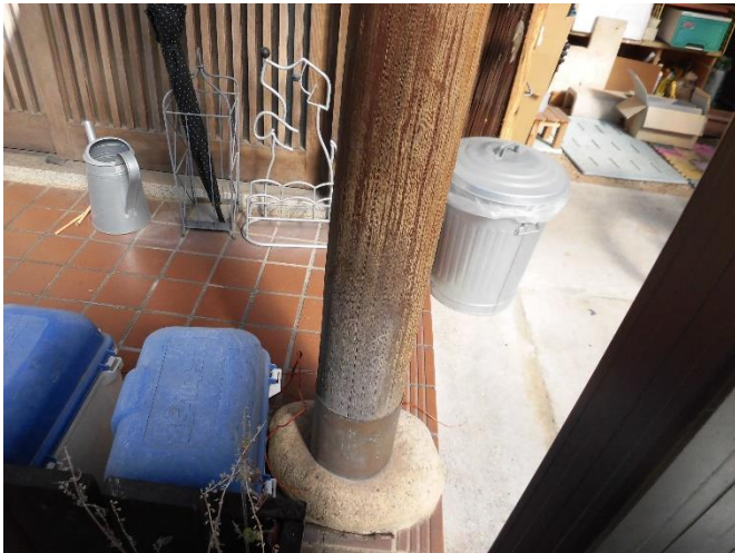
木製玄関ポーチ柱腐朽箇所 ビフォー
