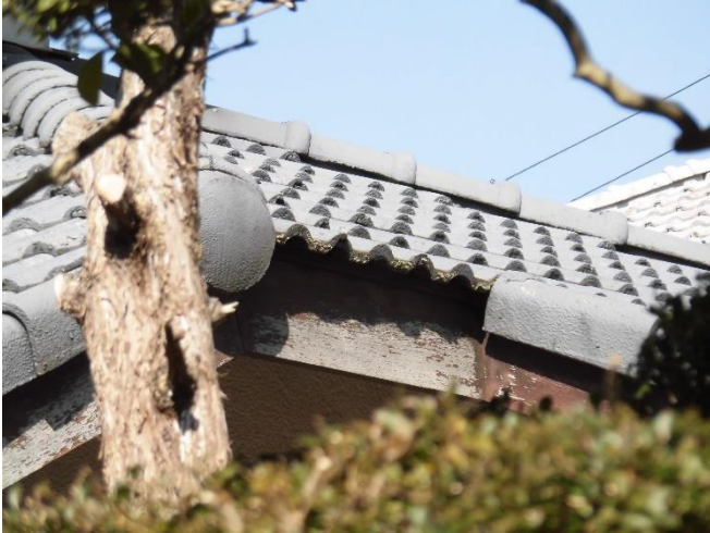
軒樋が無い ビフォー
