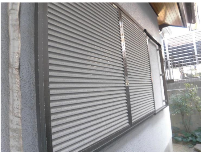
鉄製雨戸劣化箇所 ビフォー
