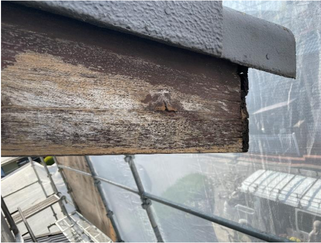
正面大屋根破風板腐朽箇所 ビフォー
