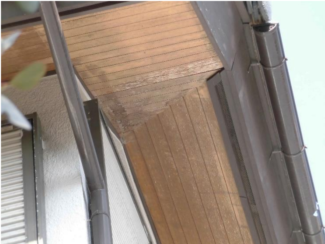
軒裏天井部劣化箇所 ビフォー
