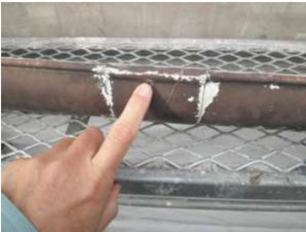
裏面 大屋根部分の雨樋が割れていました。
