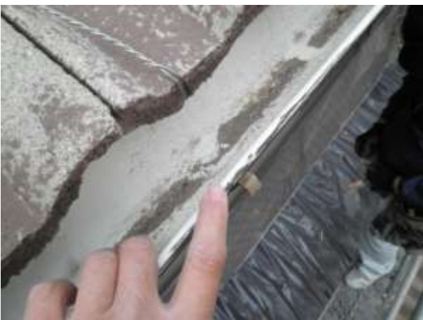
全体の雨樋の針金が切れて勾配が狂っていました。
