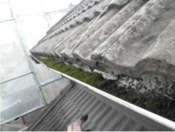
裏面の大屋根部分の雨樋がコケで詰まっていました。
